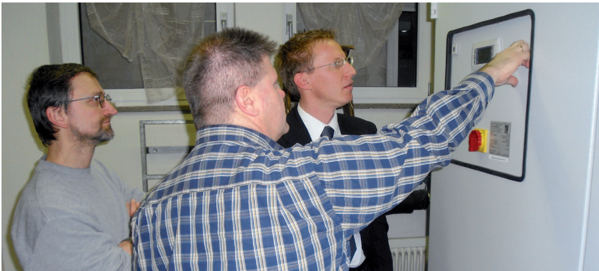
v.l.: Klaus-Georg Friedel und Guido Schilcher (Systemservice der LVG) sowie Wilhelm Bergmann (NL-Leiter SKM Skyline GmbH, Hamburg) bei der Endabnahme des Projektes
